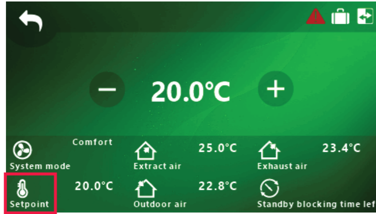
Abbildung 5.6.1.4 Bildschirmansicht ST-SA-Control und SALDA AIR Temperatursollwert
