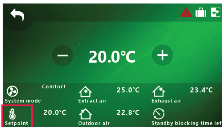
Fig. 5.6.1.4 Skärmbvy av temperaturbörvärde i ST-SA-Control och SALDA AIR
